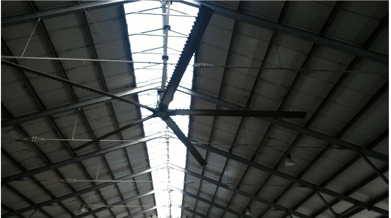
4.kép: Az „új” istállóban található, mennyezeten lévő ventilátor látható.
