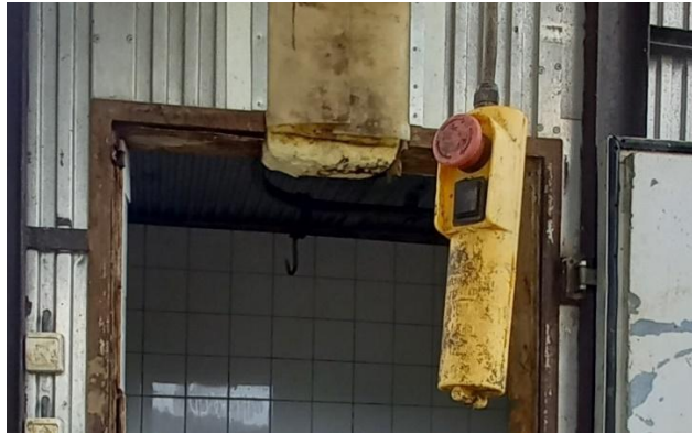
8. kép. Nem megfelelő, rozsdás ajtó (saját felvétel)
